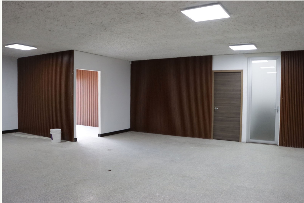
Acceso interior y luminarias
