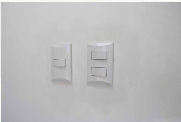
Interruptores del salón
