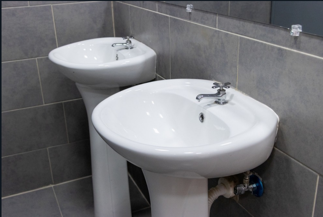
Detalle de lavamanos y azulejo
