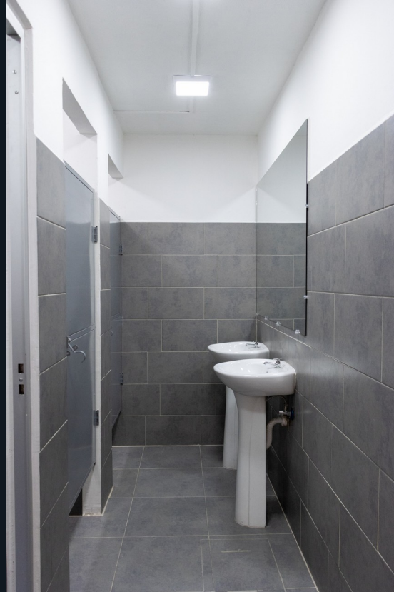
Lavamanos y revestimientos
